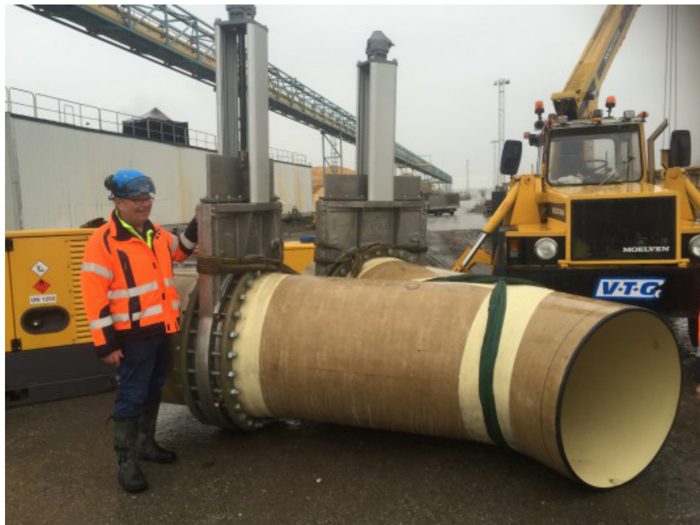
Bilden ovan visar ledningsdragning i Projekt Helios på Östrands fabrik 2016
